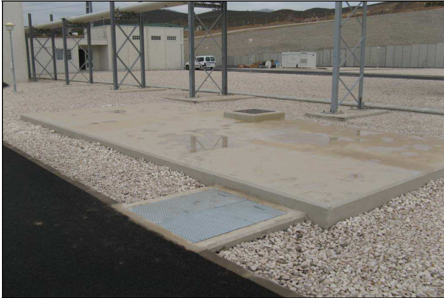
Foto 3. Vista exterior del depósito estanco de hormigón armado para recoger vertidos de aceites procedentes del transformador y arqueta colectora de aceite.
