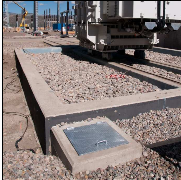
Foto 1. Vista exterior de la bancada de transformación y cubeto
